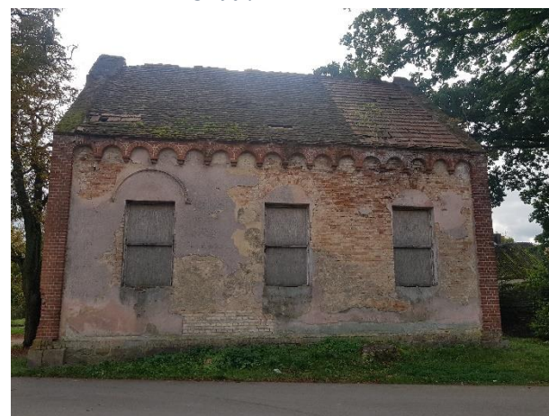
Zdjęcie 11 Niszczący zabytkowy budynek
